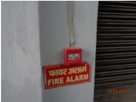
08. Fire alarm call point.JPG
