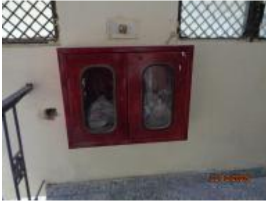
12. Fire Hose Reel.JPG
